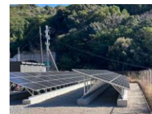
太陽光発電施設
