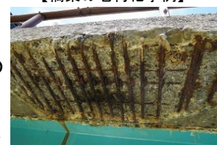
床版鉄筋の露出
