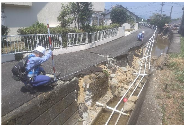
道路の被災状況調査（氷川町）
