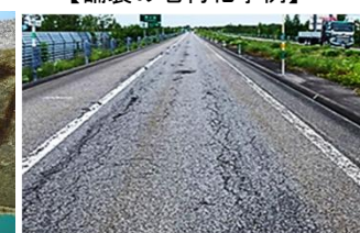
アスファルト路盤の損傷
