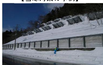
雪崩対策の例（雪崩防止柵）
