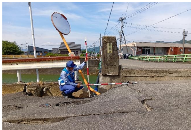
道路の被災状況調査（氷川町）
