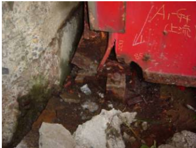
Broken girder edge due to corrosion
